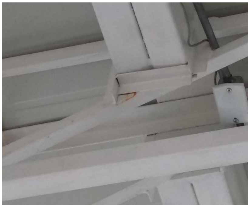
(Oxidaciones en los elementos de la estructura metálica)
