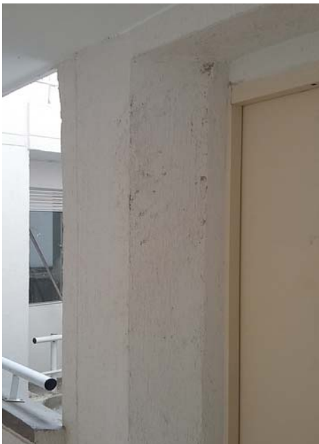
Manchas y suciedad de residuos de
