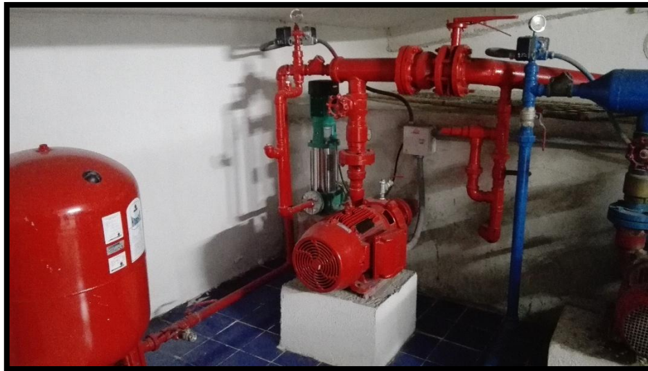
Cuarto de bombas recibido a satisfacción
